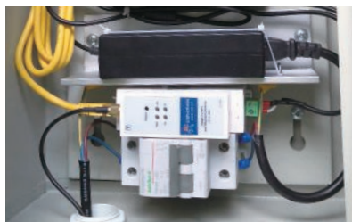
I/Oコンバーター機器OPCUAサーバー
