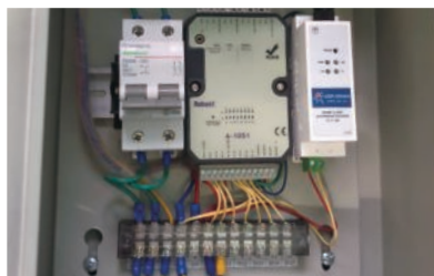
I/Oコンバーター機器コントローラ
